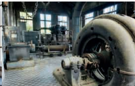
Sala dei compressori
