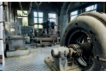
Sala de compresores
